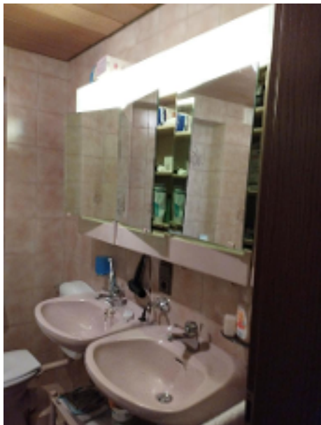
Doppelwaschbecken im Erdgeschossbad
